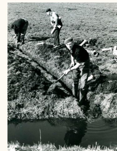
Handmatig greppelen en de greppelbuis plaatsen op een archiefoto uit de jaren vijftig. Bron: Fries Landbouw Museum. Foto J.D. de Jong
